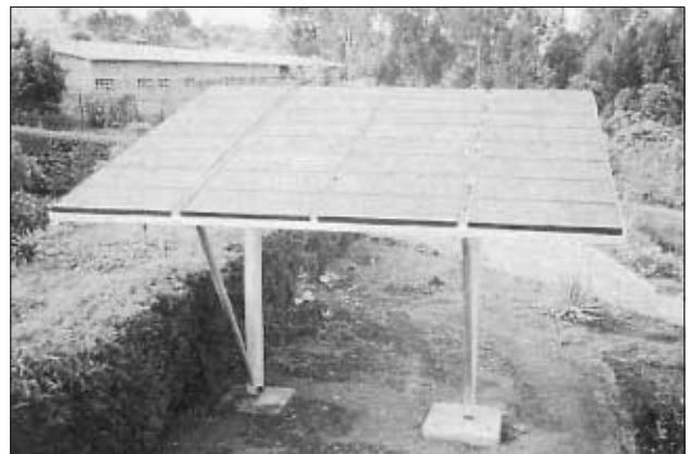
Abb. 2.3: Solare Stromversorgung für ein Spital in Rwanda
