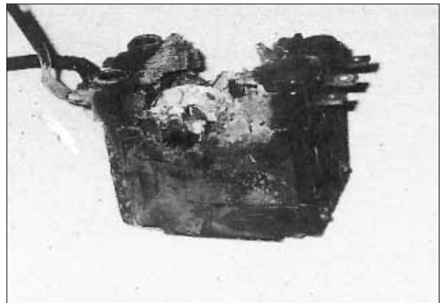
Abb. 4.5: Durch Lichtbogen zerstörter Schalter der PV-Anlage Mont Soleil
