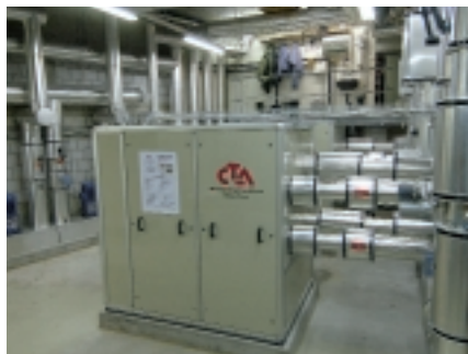
Nach der Sanierung: Neue Sole/Wasser-Wärmepumpe.
