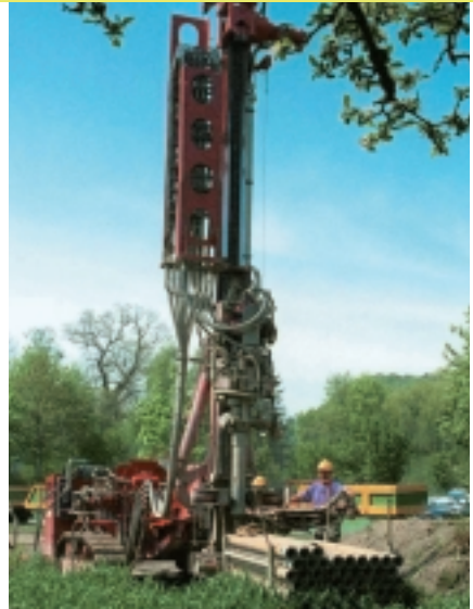
Naturenergie pur: 33 Erdwärmesonden gewinnen Wärme zum sauberen Heizen aus dem Erdreich.
