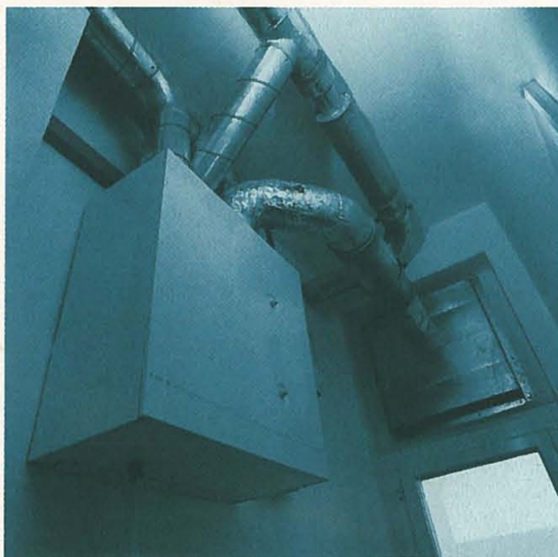
Mechanische Wohnungslüftung mit Wärmerückgewinnung als Sanierungsmassnahme: Lüftungsgerät in einem bald 100jährigen Mehrfamilienhaus.
