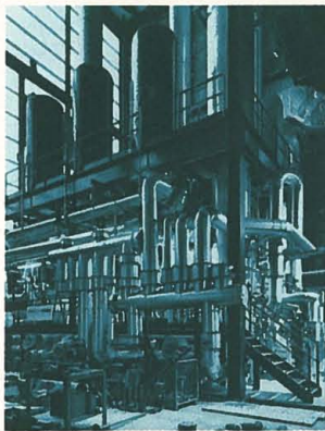
Kehrichtverbrennungsanlage Turgi: Einrichtung zur Nutzung von Abwärme.
