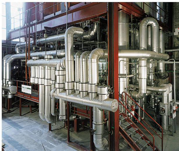
Fig. 5.2 Beispiel einer Fernwärme-Einspeisung (rechts) in der KVA Turgi
