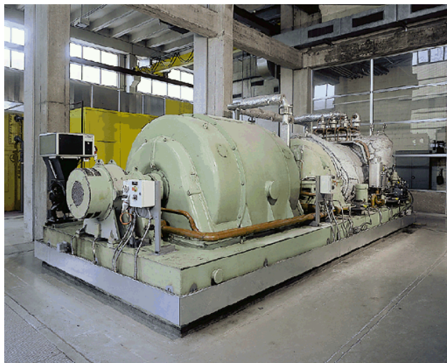
Fig. 5.1 Beispiel einer Dampfturbine mit Generator in der KVA Turgi
