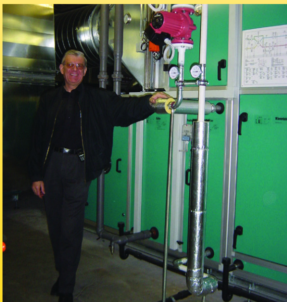
Betriebsleiter Ruedi Lieberherr vor der Klimaanlage mit Registervormärmung.
