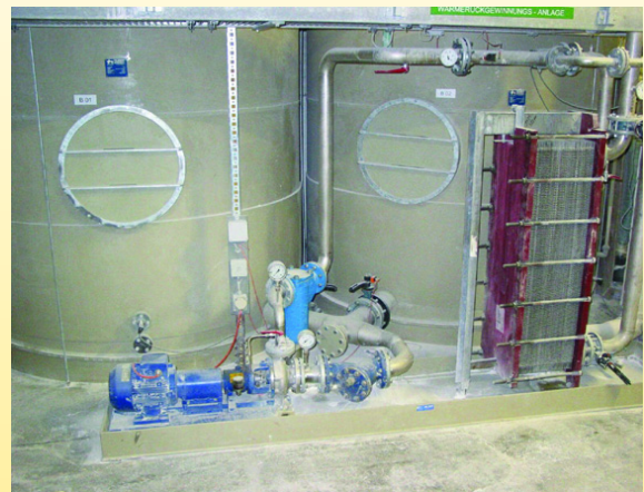
Ansicht der WRG, bestehend aus Stapeltanks, Pumpe und Plattenwärmetauscher.
