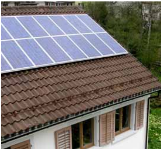
Abbildung 24: Photovoltaikanlage auf dem Schrägdach eines Einfamilienhauses in Zürich. Mit 3,3 kW hat die Installation eine typische Anlagengrösse der „Solaraktion“. Quelle: BE Netz, Luzern
