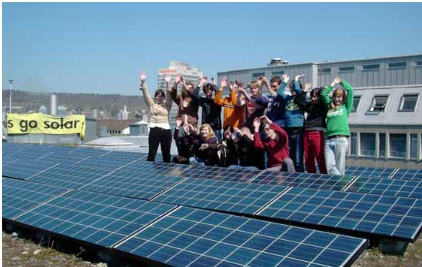
Abbildung 26: Lernen mit Solarkraft. Swisscom Lehrlinge halfen im Rahmen der Solaraktion und des JugendSolarProjekts mit, die 8,5 kW Photovoltaikanlage in Zürich zu installieren. JugendSolarProjekt hat sich zum Ziel gesetzt, jährlich mindestens zwanzig Solaranlagen zu installieren. Für Swisscom ist Solarstrom Teil des Umweltsponsorings. Quelle: BE Netz, Luzern
