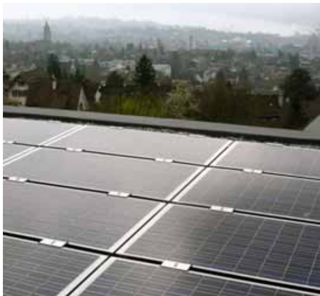
Abbildung 25: Photovoltaikanlage auf dem Flachdach eines Einfamilienhauses in Zürich. Die Anlage weist eine Leistung von 5,76 kW aus. Quelle: BE Netz, Luzern
