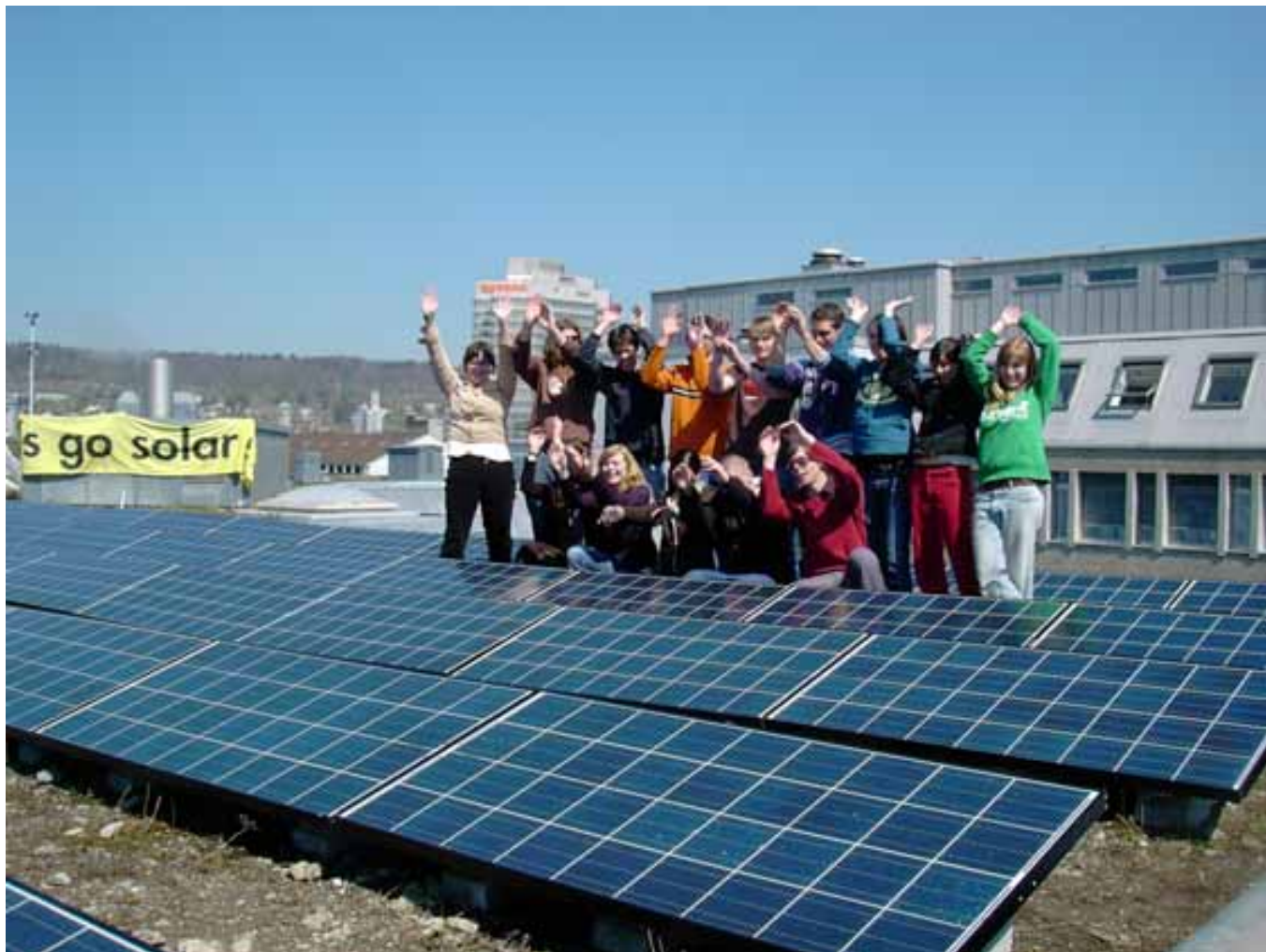
Abbildung 49: Lernen mit Solarkraft. Swisscom Lehrlinge halfen im Rahmen der Solaraktion und des JugendSolarProjekts mit, die 8,5 kW Photovoltaikanlage in Zürich zu installieren. JugendSolarProjekt hat sich zum Ziel gesetzt, jährlich mindestens zwanzig Solaranlagen zu installieren. Für Swisscom ist Solarstrom Teil des Umweltsponsorings. Quelle : BE Netz, Luzern
