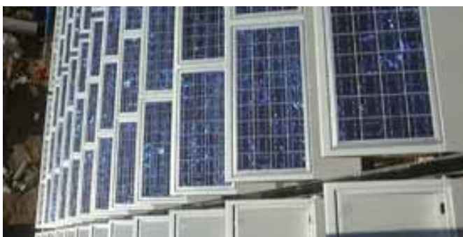
Abbildungen 30 bis 32: Renovation und innovatives Design beim niederländischen Energieforschungszentrum. Bei Renovationsarbeiten und beim Anbau sind insgesamt 102,9 kW Solarkraft integriert worden. Die Bilder zeigen eine Innen- und Aussensicht des geschwungenen, semi-transparenten Photovoltaikdaches sowie eine Sicht (von oben) auf die Module der Photovoltaikfassade. Quelle: ECN, Niederlande / BEAR Architecten, Niederlande
