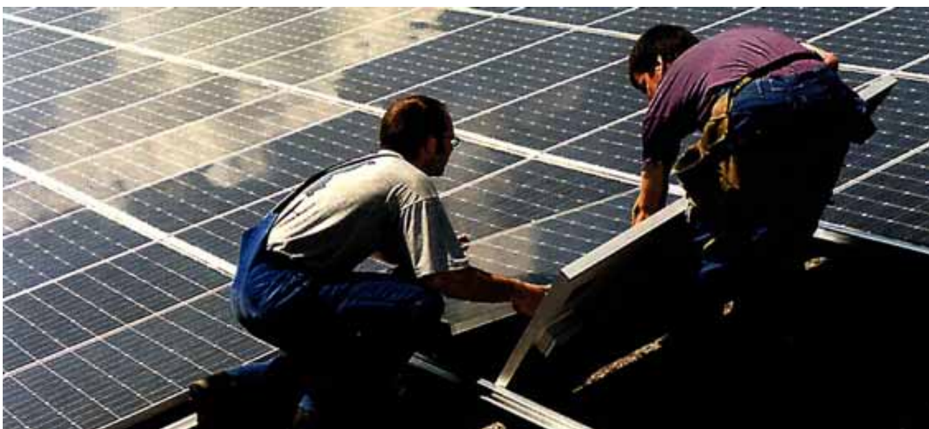
Abbildungen 41 und 42: Photovoltaikanlagen in Hünenberg (ZG). Ein Sportzentrum und ein Scheunendach beherbergen je eine Anlage. Quelle: U. Bühler, Cham
