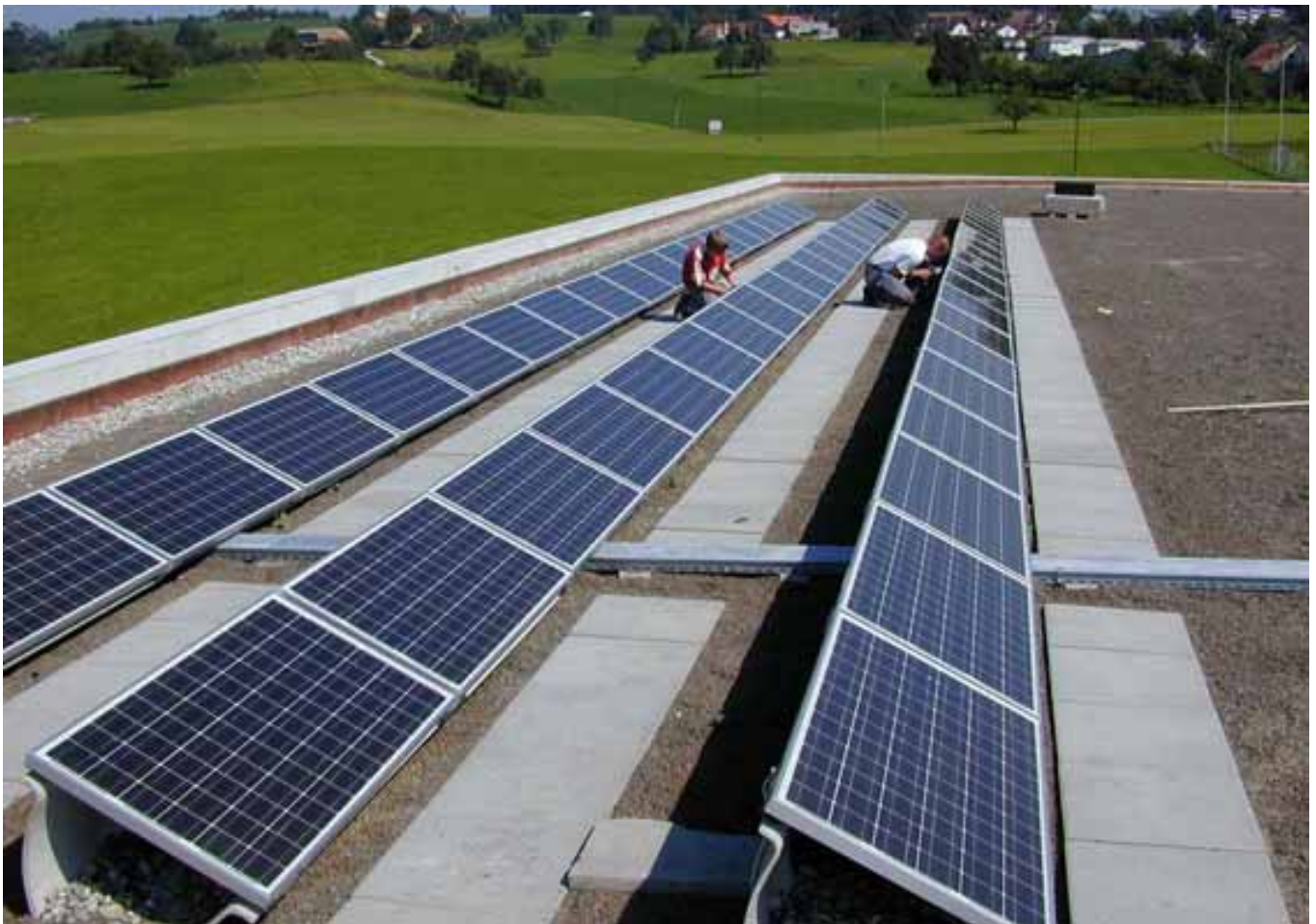
Abbildung 34: Solarstromanlage in Andwil (SG) . Der Gemeinderat regte die Erstellung einer Photovoltaikanlage im Zusammenhang mit dem Bau einer neuen Turnhalle an. Mit der Inbetriebnahme der Anlage im September 2004 hat für die Gemeinde und Elektra Andwil die Ära der eigenen lokalen Stromproduktion begonnen. Quelle: Gemeinde Andwil / Technische Betriebe Gossau
