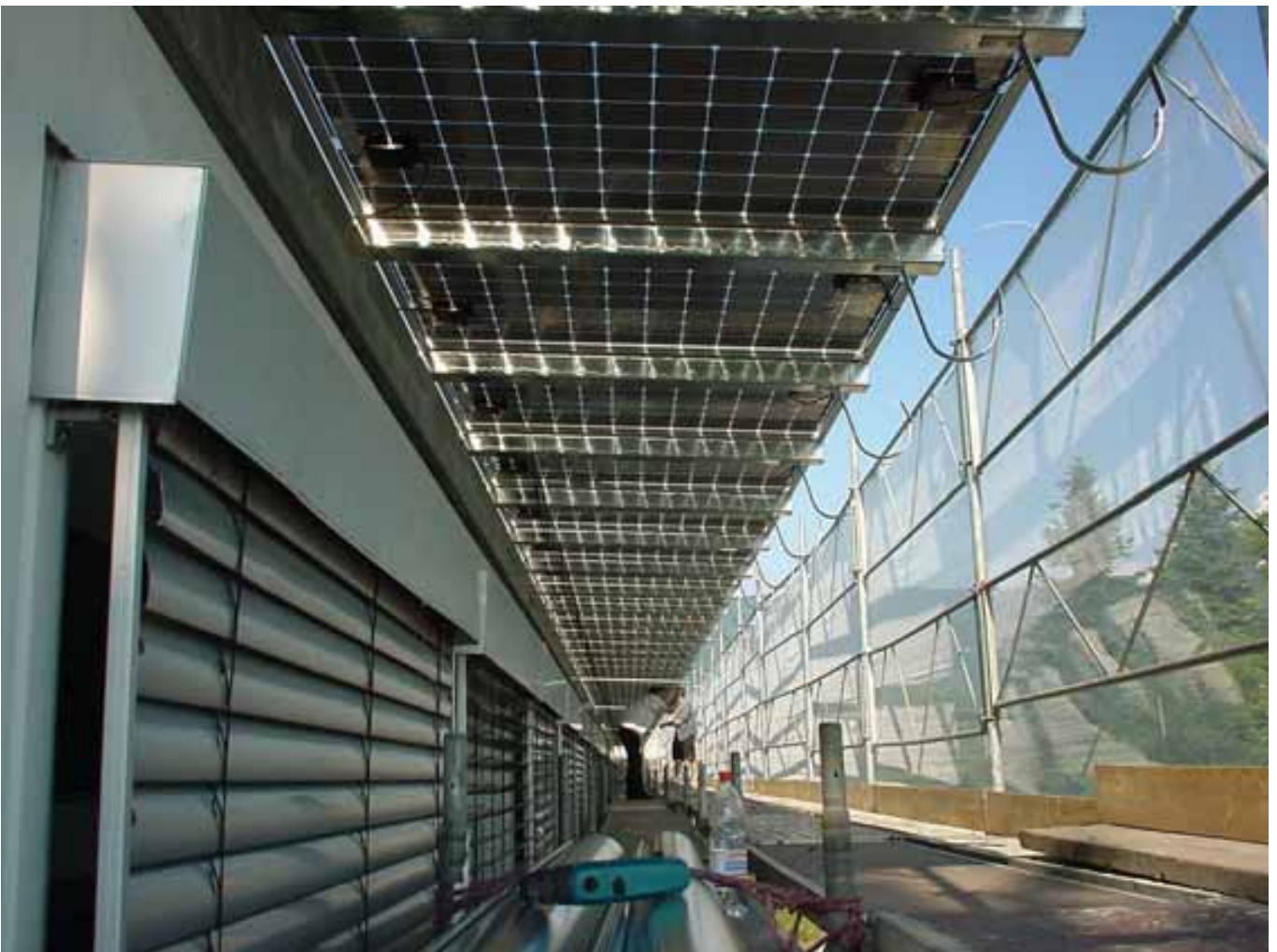
Abbildungen 7 und 8: Ingenieurschule Lullier in Jussy (GE) vermittelt Photovoltaik in baulicher und praktischer Hinsicht. Das Projekt umfasst nicht nur 522 Module mit einer Gesamtleistung von 83 kW, sondern ebenfalls Lern- und Anschauungsmaterial für die Jugendlichen rund um das Thema Chancen und Grenzen der Solarenergie. Die Abbildungen zeigen die Anlage aus der Vogelperspektive sowie die Abschlussarbeiten. Quelle: Sunwatt Bio Energie, Chêne-Bourg
