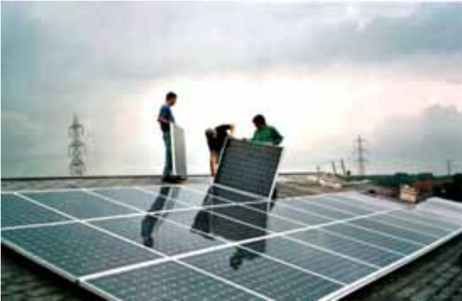
Abbildung 28: Montage der Module auf dem Schulhaus Konstanzmatt in Rothenburg (LU). Quelle: BE-Netz (vormals Energie Kottmann), Luzern
