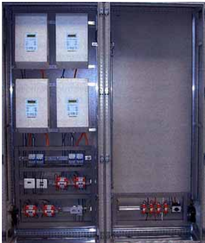
Abbildung 35: Steuerschrank mit Wechselrichtern. Sowohl die Anordnung auf dem Dach wie auch im Schrank lassen eine Kapazitätserweiterung um 100% zu. Quelle: Gemeinde Andwil / Technische Betriebe Gossau
