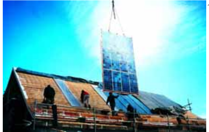
Abbildung 29: Montage in 20 Minuten. Demonstration der Montage mit vorfabrizierten Komponenten innert 20 Minuten für eine 1,4 kW Anlage. Quelle: Stromaufwärts, Österreich
