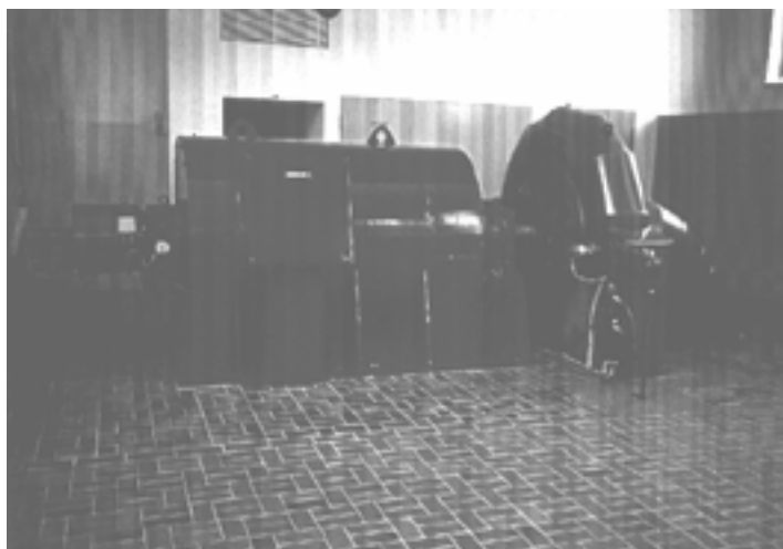
Ein Beispiel für moderne Technologie im Kleinwasserkraftbereich.
