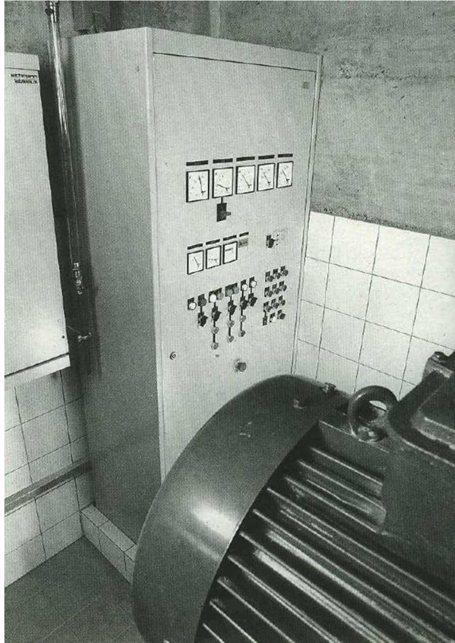
Steuerschrank/ Armoire de commande
