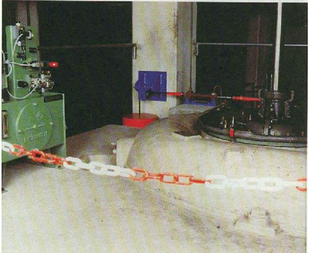
Francis-Turbine mit Hydraulikaggregat Turbine Francis avec agrégat hydraulique
