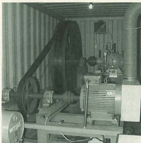
Transmission de puissance : A l'arrière plan le multiplicateur planétaire, à gauche la transmission à courroie, au premier plan la génératrice avec le tuyau d'air pour la réfrigération.
