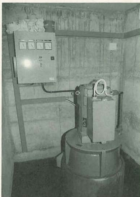
Blick ins Innere des Turbinenhäuschens. Die Frequenz kann zwischen 45 und 55 Hertz gewählt werden. Wegen den Übertragungsverlusten ist die Spannung auf 400 Volt (anstatt 380) eingestellt.
