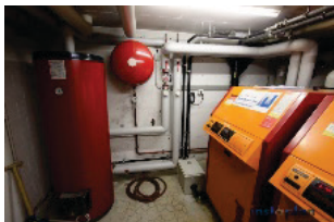
Abbildung 4: Boiler neben Heizzentrale
