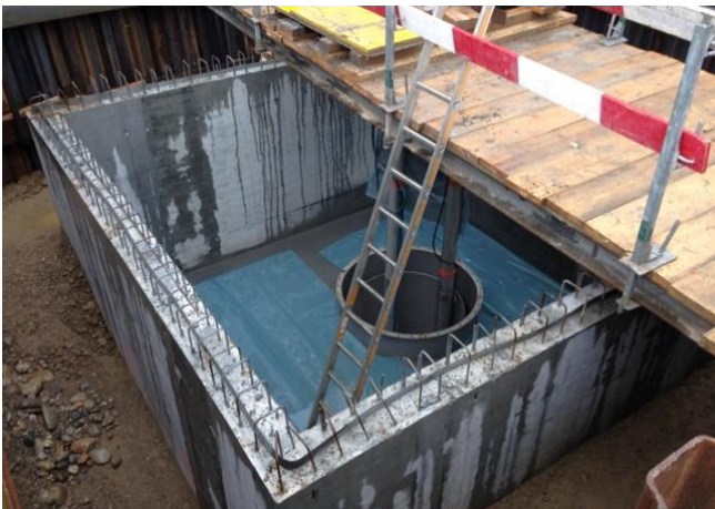
Grundwasserbrunnen in Aarau mit 1.8 MW © eicher+pauli
