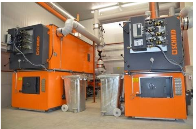
Holz Schnitzelfeuerung Felben-Wellhausen (TG) © Schmid
