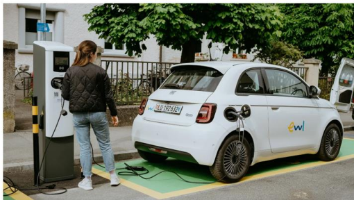
Ladestation in der grünen Zone Eichmattstrasse
