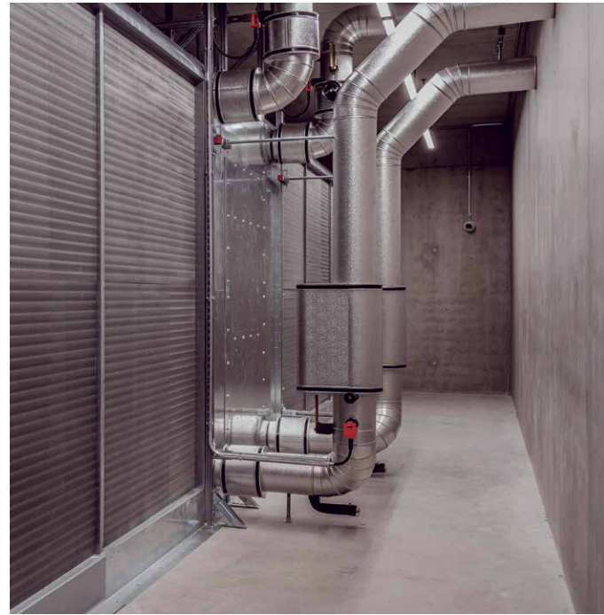
Blick auf den Luft-Wasser-Wärmetauscher. Er überträgt die Wärme von der erhitzten Luft auf einen Wasser-Kreislauf, der sie zur Heizzentrale transportiert. Dort dient sie als Energiequelle für Wärmepumpen, welche die Temperatur erhöhen, damit die Wärme vom Fernwärmenetz genutzt werden kann. (Foto: Infomaniak)
