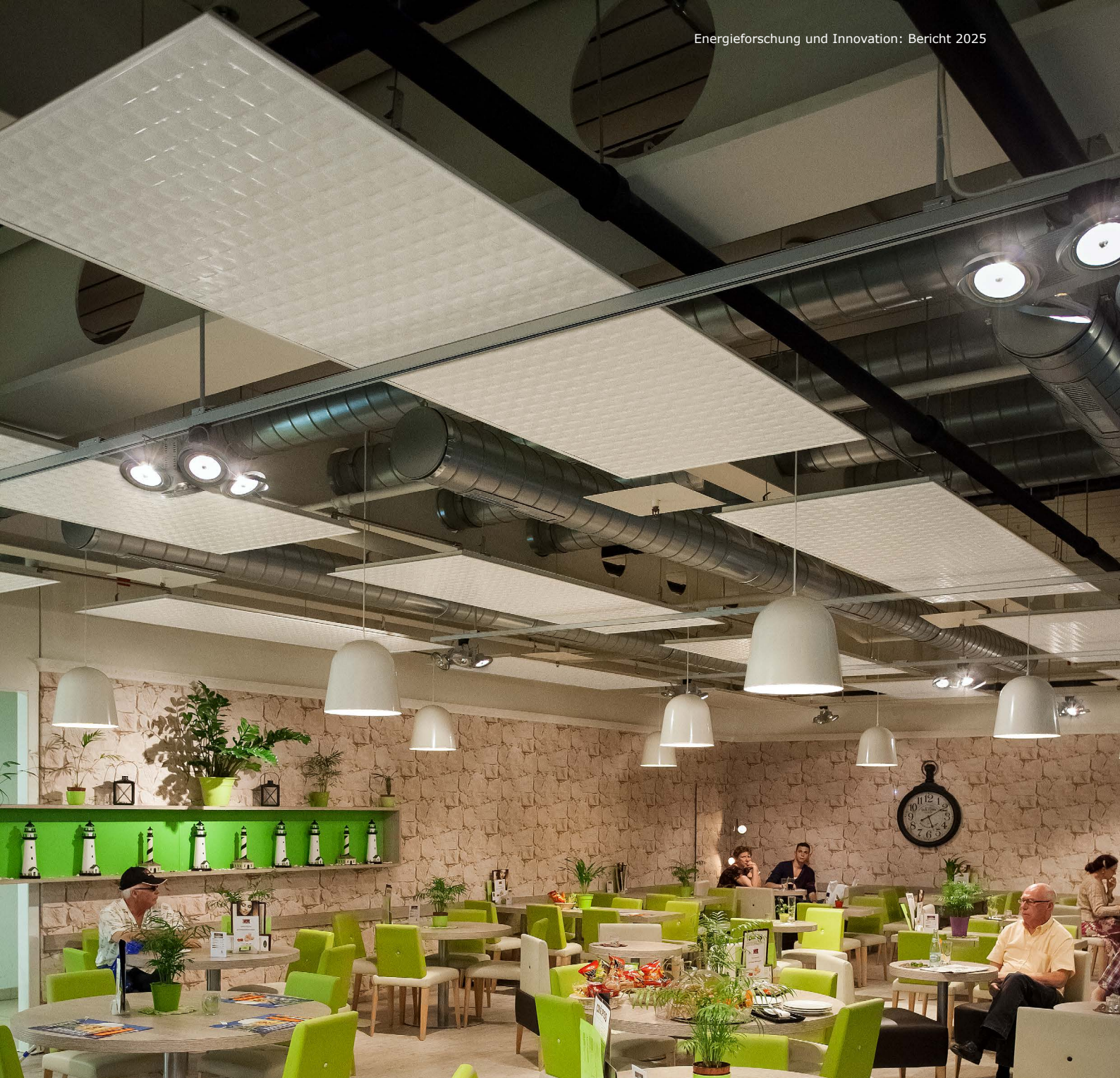
Grossflächige Deckenheizungen ermöglichen die Abgabe von Heizwärme auf einem niedrigen Temperaturniveau (Bildquelle: SOLTOP Energie AG).
