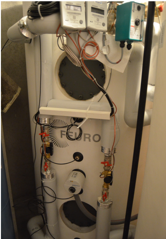
Dieser Heizungsspeicher mit 762 l Füllvolumen wurde im Zuge des Projekts mit PCM-Kapseln befüllt. Foto: Schlussbericht SunStore
