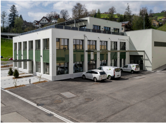
Unter dem asphaltierten Vorplatz des Elektrizitätswerks Wald wurde 2022 im Zuge des neu errichteten Betriebsgebäudes ein Asphaltkollektor aus 17 Modulen verlegt. Foto: EW Wald AG
