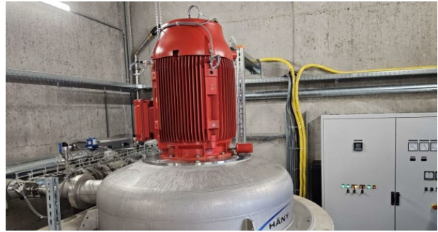
Kleine, speziell für den Standort dimensionierte Pelton-Turbine mit einer Leistung von 117 kW bei einer Durchflussmenge von 30 l/s und einer Nettofallhöhe von 467 m, Inbetriebnahme im September 2025, Nutzung des Trinkwassers der Gemeinde Schwanden (GL) (Quelle: Häny & Kobel Elektrotechnik AG)
