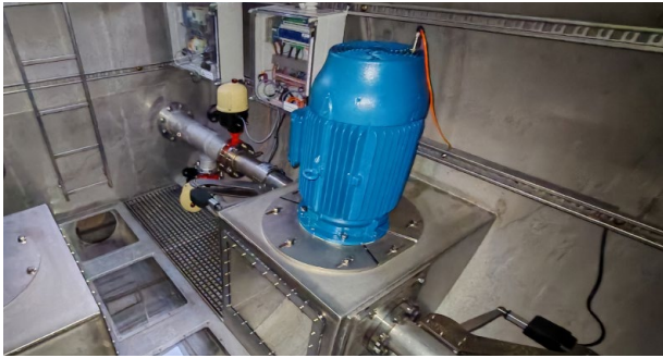
Kleine standardisierte Pelton-turbine mit 15 kW für einen Durchfluss von 32 l/s und eine Nettofallhöhe von 58 m, Inbetriebnahme im Januar 2026, Nutzung des Trinkwassers der Gemeinde Zillis-Reischen (GR) (Quelle: ENSY AG)
