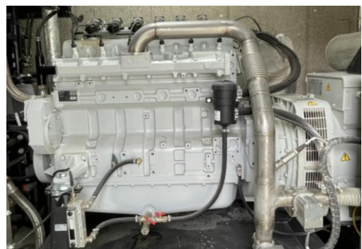
Bild 2.43 Beispiel eines Holzvergaser-BHKW mit 100 kW Nutzwärmeleistung und 50 kW elektrischer Leistung, Baujahr 2022 und Standort Kanton Zürich [55]. Oben: Holzvergaseranlage mit zwei-stufiger Vergasung (Lipro) Unten: Gasmotor mit Drei-Wege-Katalysator.
