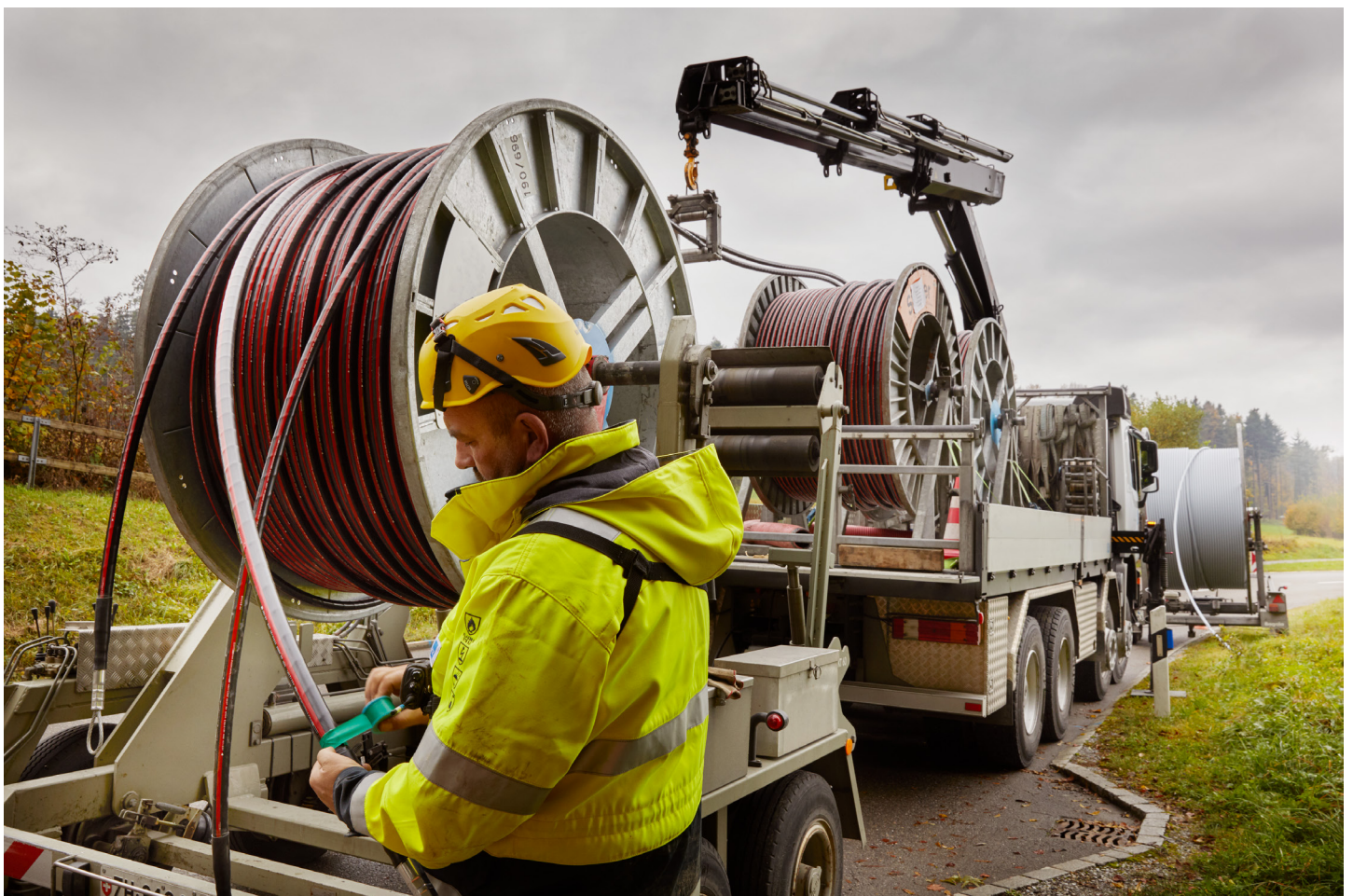
Wenn es gelingt, Last- und Einspeisespitzen im Verteilnetz zu glätten, kann der Netzausbau verringert oder zumindest verzögert werden. Foto: EKZ
