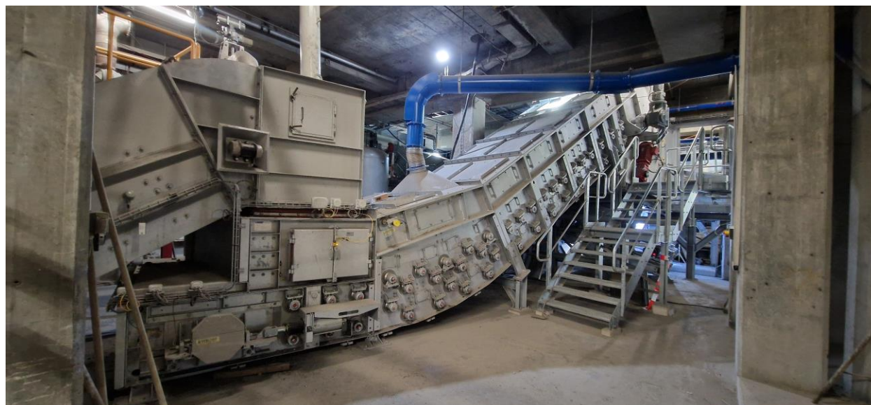
Abbildung 1: Neuer Trockenaustrag für Schlacke bei der KVA Trimmis. (Bildquelle: GEVAG).
