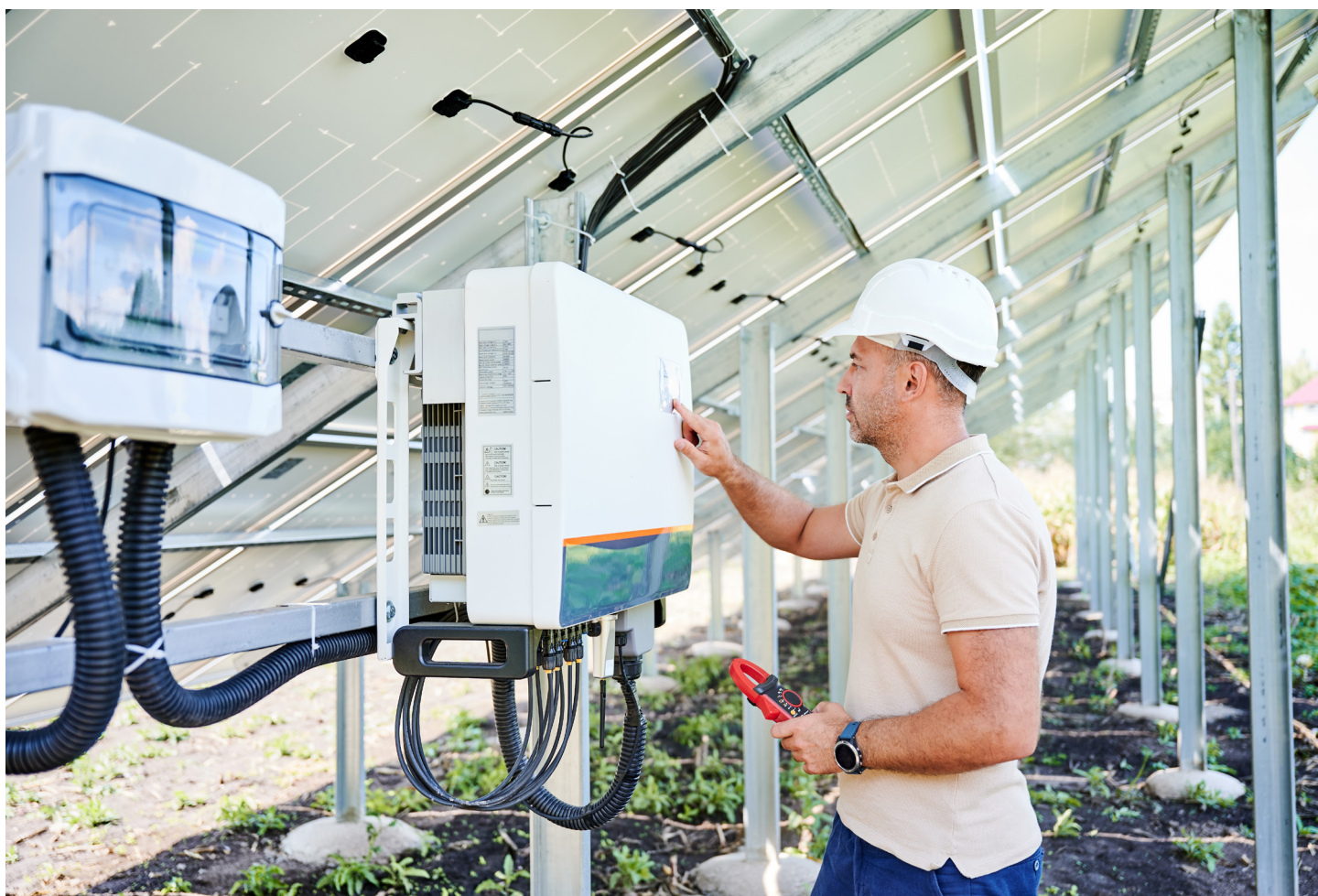
Über den NA-Schutz des Wechselrichters kann eine PV-Anlage bei Bedarf vom Netz getrennt werden. Foto: Shutterstock
