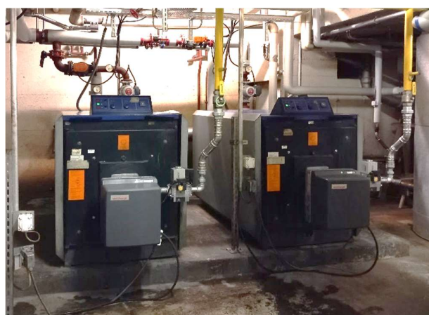
Figure 2 : Chaudières au gaz – 2x 400 kW
