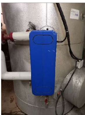
Figure 4 : Chauffe-eau avec échangeur externe alimenté par les chaudières
