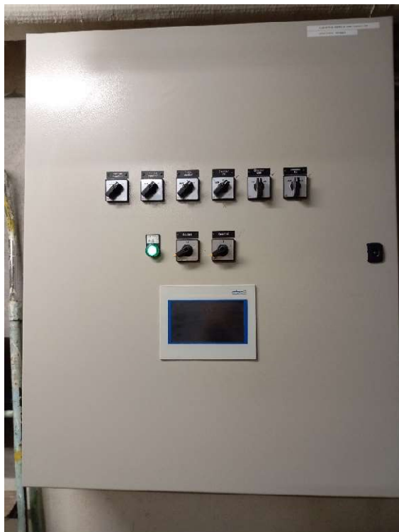
Figure 5: Tableau MCR en chaufferie
