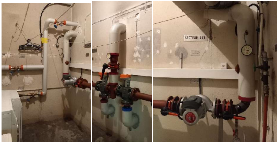
Figure 3 : Collecteur de chaleur en chaufferie – Secteur Ouest à gauche, secteur Est à droite
