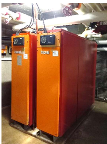
Figure 4 : Chauffe-eaux alimentés par les chaudières
