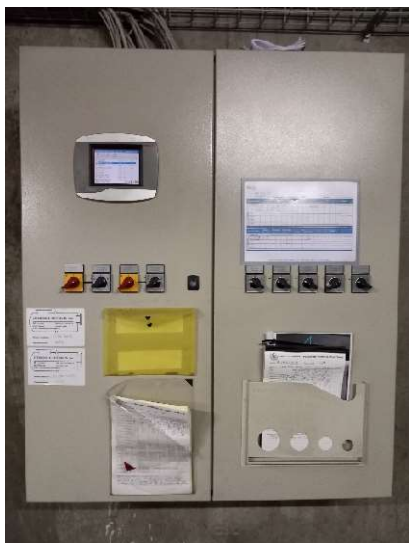
Figure 5 : Tableau MCR en chaufferie
