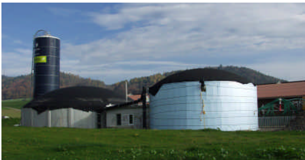
Fig. 17: Fermenter (rechts) Betriebsgebäude (mitte) und Nachgärer (links)
