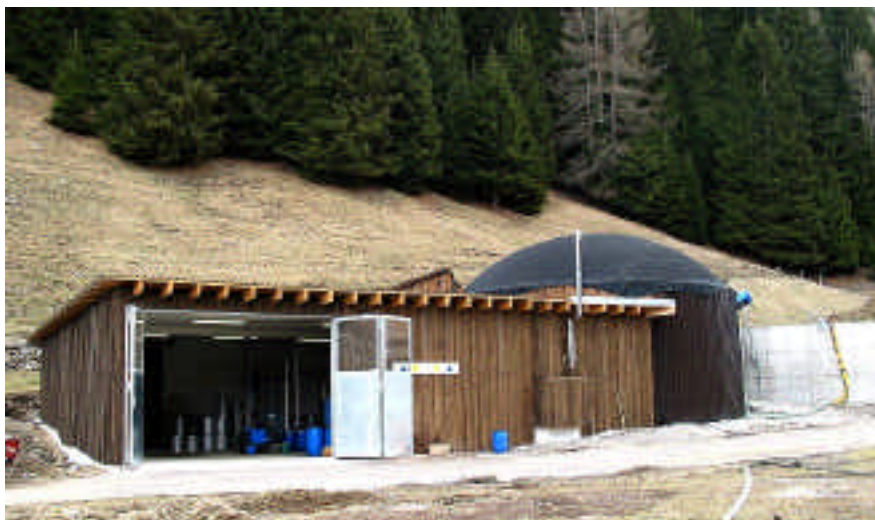
Fig. 2: Ansicht einer landwirtschaftlichen Biogasanlage mit Co-Vergärung in Davos
