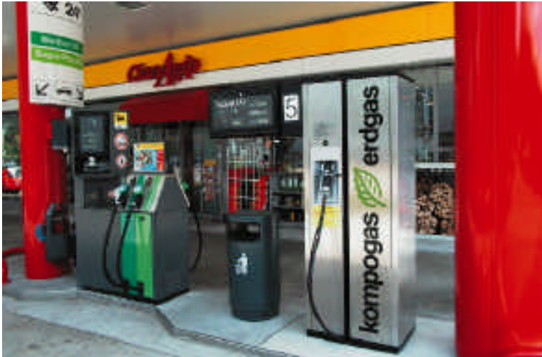
Fig. 15: NATURGAS Tankstelle in Zürich Nord.
