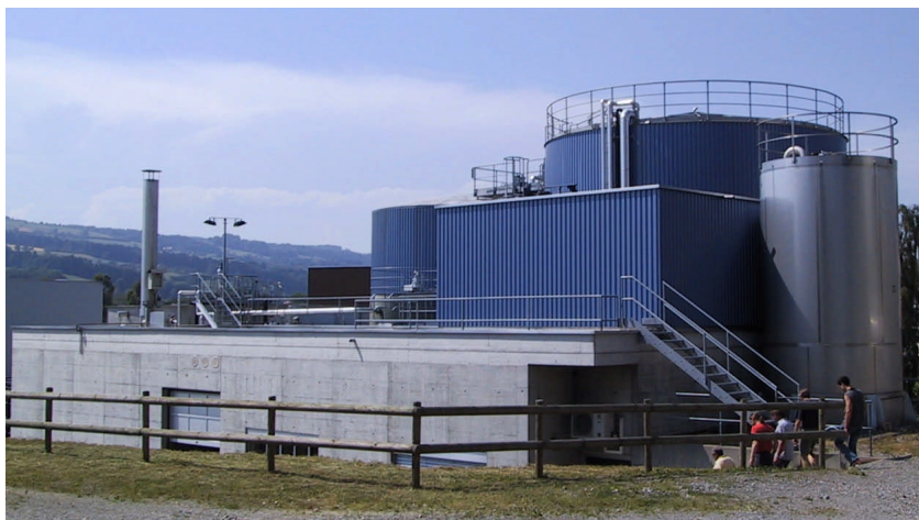
Fig. 5 Biogasanlage der Hochdorf Nutritec AG, Hochdorf
