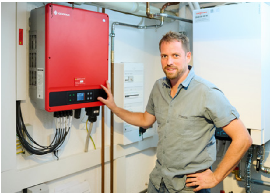
Alberto Conelli im Technikraum: mit der roten Steueranlage der Photovoltaikanlage und jener der Wärmepumpe.
