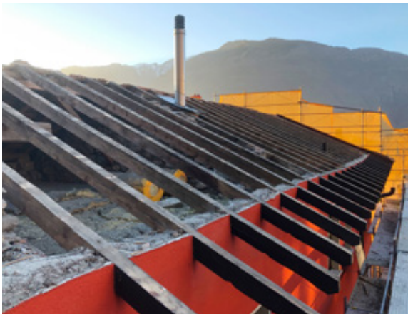
Zwei Jahre nach dem Bezug des Hauses leckte das Dach und musste ersetzt werden.
