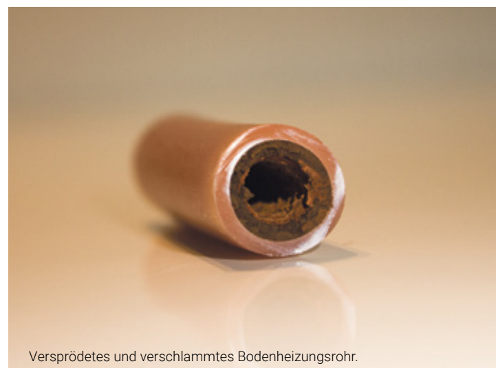
Versprödetes und verschlammtes Bodenheizungsrohr.
