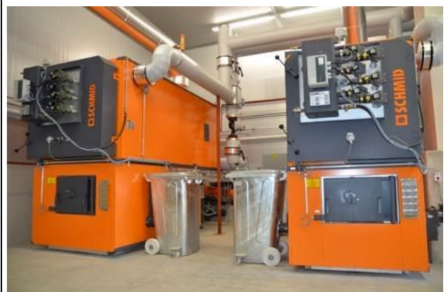
Holzsnitzelfeuerung Felben-Wellhausen (TG)
