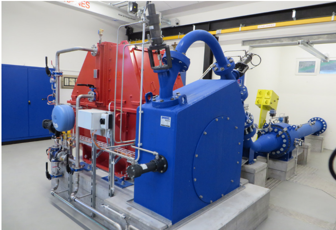
Die Technischen Betriebe Vilters-Wangs haben drei Wasserkraftwerke (im Bild: Kraftwerk Grossbach). Diese werden betrieben, wenn die Stromnachfrage im eigenen Netz hoch ist. So können hohe Leistungsbezüge aus dem vorliegenden SAK-Netz vermieden werden. Foto: TB Vilters-Wangs
