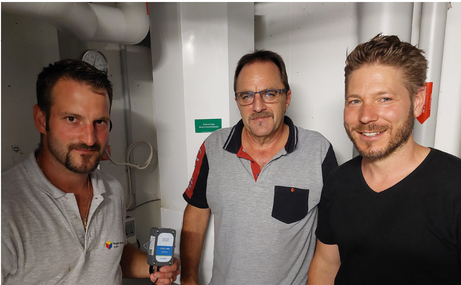
Abbildung 2: Das Solarthermie-Service-Team der Regionalwerke AG Baden und LORALARM bei der Installation des ersten Solarthermie-Monitorings.
