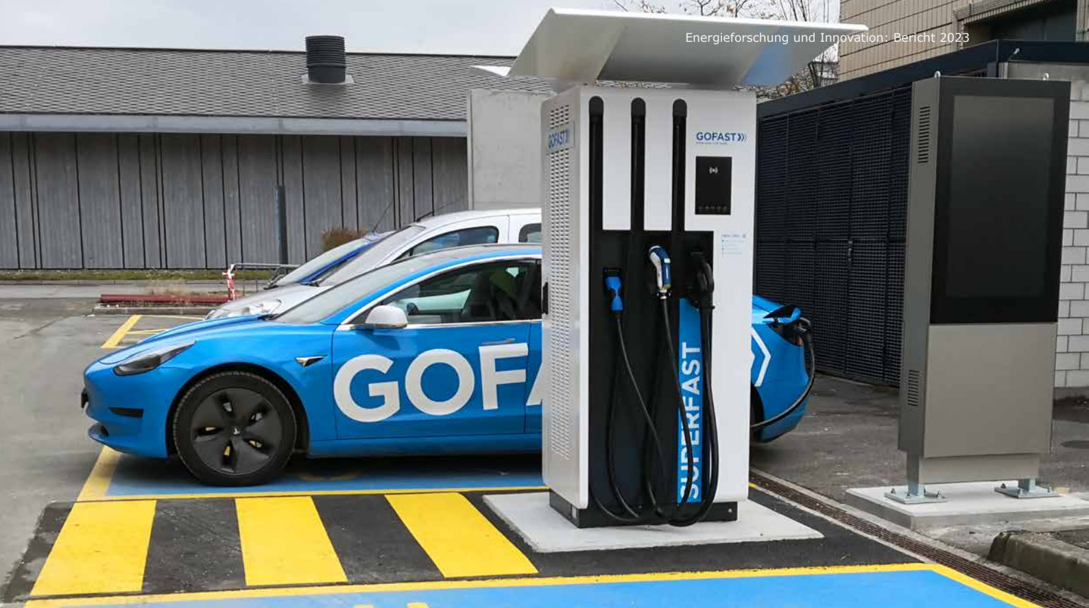
Die Schnellladestation auf dem Campus der EPFL kann zwei Elektroautos innert 15 Minuten mit ausreichend Strom versorgen, um 100 km weit zu fahren (Quelle: Schlussbericht MESH4U).
