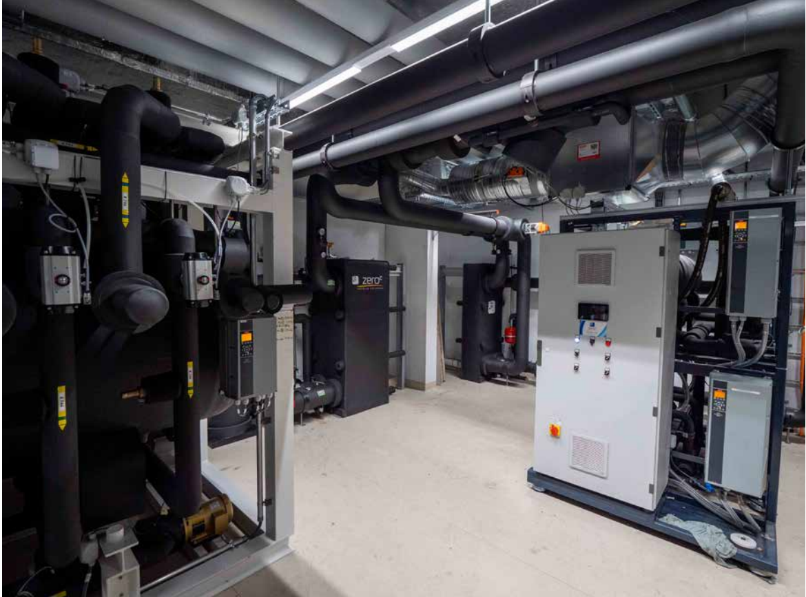
In der Energiezentrale des Anergienetzes kühlt das Grundwasser das CO 2 über einen Wärmetauscher ab respektive erwärmt es (Bildquelle: HES-SO Valais-Wallis).
