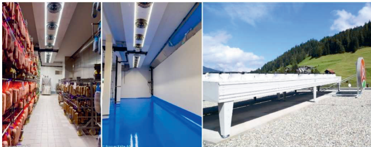
Abbildung 2: Oben: CO 2 -Booster-Kühlsystem mit Wärmerückgewinnung und CO 2 -Luft/Wasser-WP bei Micarna in Tinizong (GR). Hersteller: Kältering AG / Enex srl (IT), Anlagenbauer: Brasser Kälte AG (Fotos: C. Arpagaus, 25. April 2025). Unten: Fleischtrocknung (Bündnerfleisch) in einem Kühlraum. Die Trockenapparate sind an der Decke montiert (Fotos: Brasser Kälte AG).
