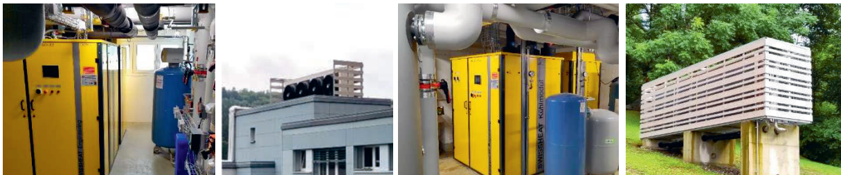
Abbildung 2: Wärmepumpen und Luftwärmetauscher der beiden Häuser K8 (links) und K6 (rechts).
