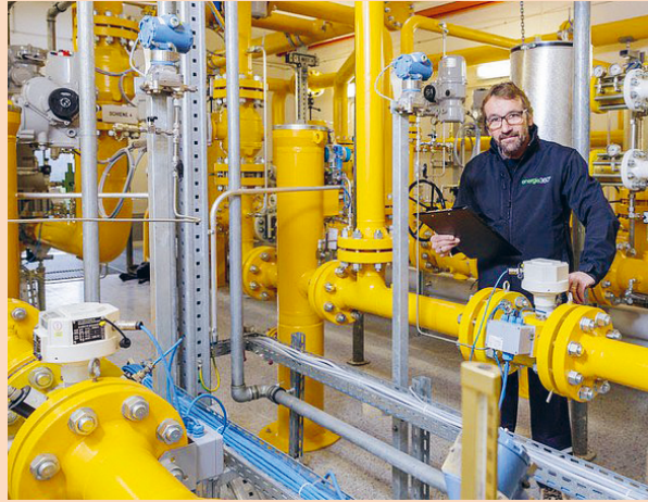
Abbildung 3: Druckreduzier- und Messstation (Quelle: Energie 360°).
