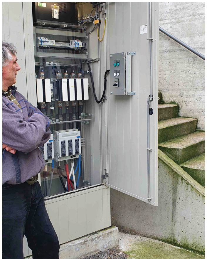
Landwirt Otto Wartmann neben der Installation, mit der auf dem Holzhof die Notstromversorgung mittels erneuerbaren Energien untersucht wurde. Foto: Fleco Power
