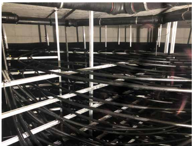
Blick ins Innere eines Eisspeichers, bevor er mit Wasser gefüllt wurde. Über die ringförmig angeordneten Rohre wird dem Wasser im Betrieb Wärme entzogen, wodurch es schliesslich von unten nach oben zu gefrieren beginnt. Ganz aussen wurde bewusst ein Freiraum belassen, damit dort kein Eis entsteht, das Schäden an der Wand verursachen könnte. Abgetaut wird der Eisspeicher durch ein zweites Rohrsystem, das an den Wänden installiert wurde. Der Eisspeicher taut daher jeweils von aussen nach innen auf (Bildquelle: Viessmann Schweiz AG).
