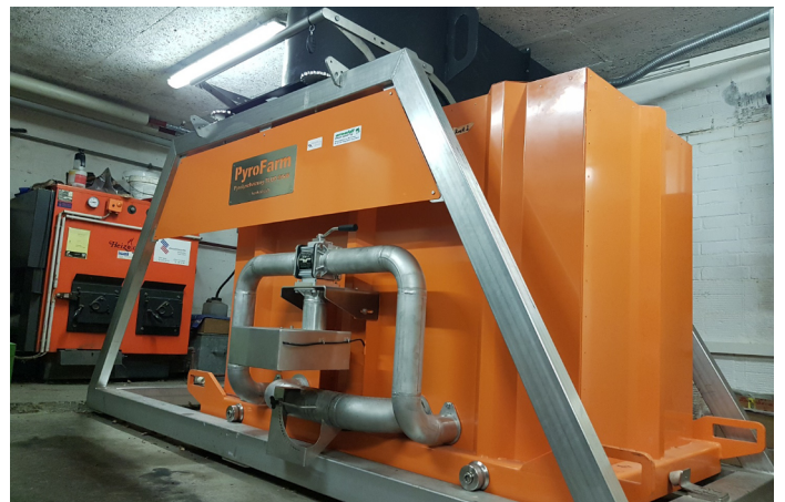
Auf einem Bauernhof in Stettlen (BE) läuft seit November 2020 eine Pyrolyse-Anlage, die Holz hackschnitzel als Substrat nutzt. Hier werden jährlich rund 50'000 kWh Heizwärme und 5 t Pflanzenkohle produziert. Die Wärme wird für die Heizwärme- und Warmwasserproduktion von vier Wohnungen verwendet. Foto: Fridolin Hanel
