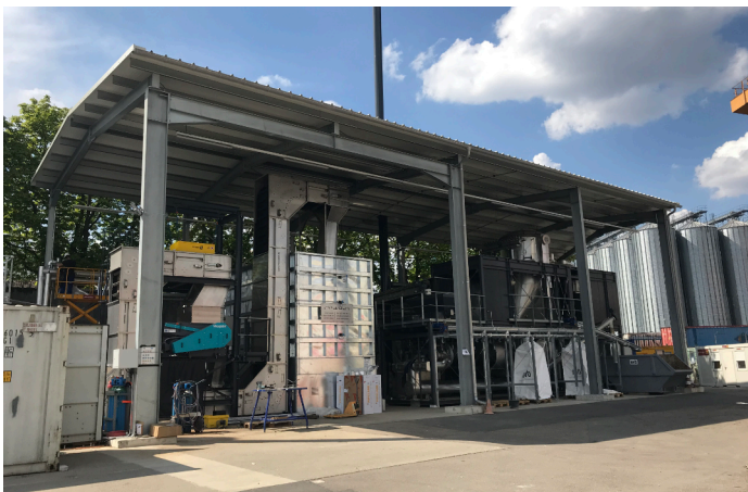
Die Basler Energieversorgerin IWB betreibt seit 2021 eine Pyrolyse-Anlage. Diese erzeugt aus der Verwertung von Holz Fernwärme für rund 170 Haushalte (insgesamt 1'500'000 kWh) und 550 Tonnen Pflanzenkohle für Hobbygärtner, Gärtnereien und die Landwirtschaft. Foto: IWB
