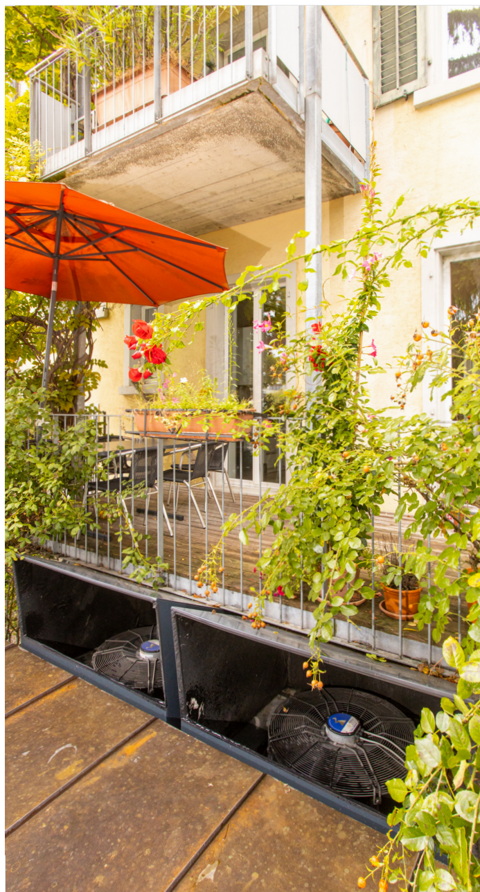
Nach Erkenntnis der LICs-Studie können Luft/Wasser-Wärmepumpen ein zentraler Bestandteil einer kostengünstigen Sanierungslösung sein. Foto: Giovanni Pirajno
