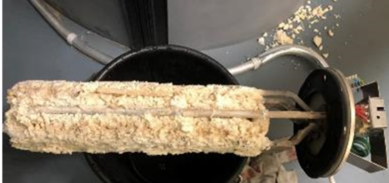
Abbildung13: Verkalkter Heizstab konnte auf Grund des Monitorings detektiert werden. (Quelle: BFE Wärmepumpen Feldmessungen durch das WPZ)
