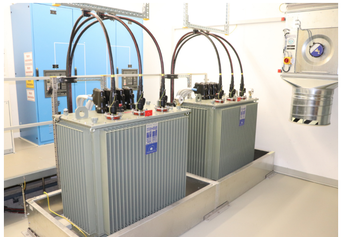
Der ZEV Erlenmatt-Ost ist über zwei 630 kVA-Transformatoren (im Bild) ans Mittelspannungsnetz des Basler Stromversorgers IWB angeschlossen. Foto: B. Vogel
