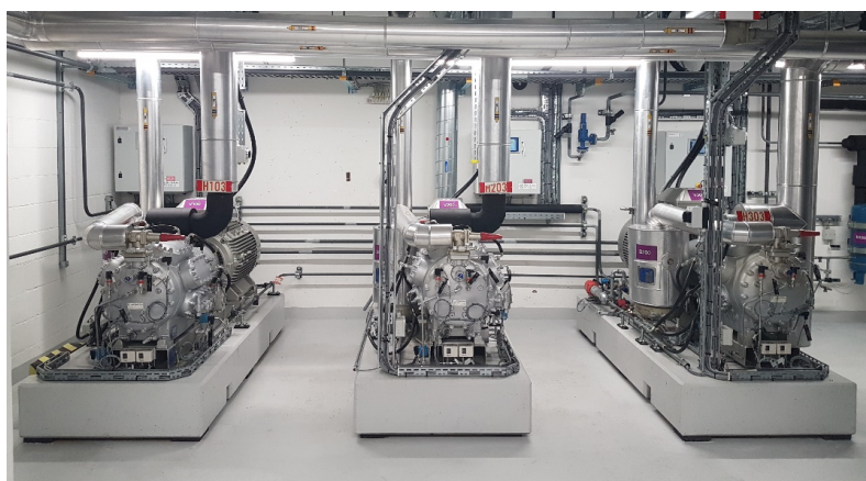
Bild 4: Blick in die kombinierte Kälte-Heizzentrale. Links die beiden Kälteverdichter und rechts der Verdichter der Wärmepumpe.
