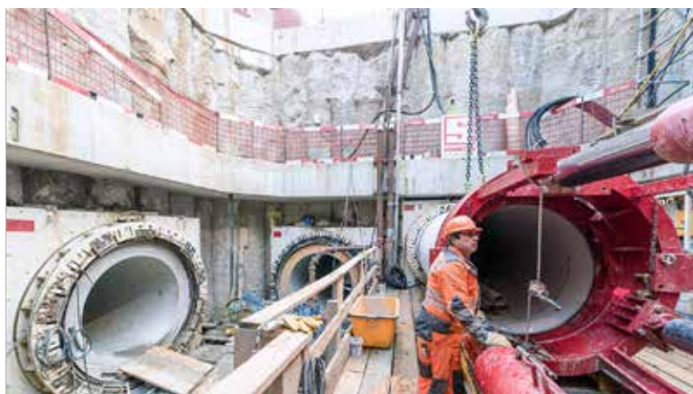
Im Untergrund der Stadt Zug: 2017 erfolgte der Spatenstich für den Wärme- und Kälteverbund Circulago, 2020 ging die erste Quartierzentrale in Betrieb. Foto: Andreas Busslinger
