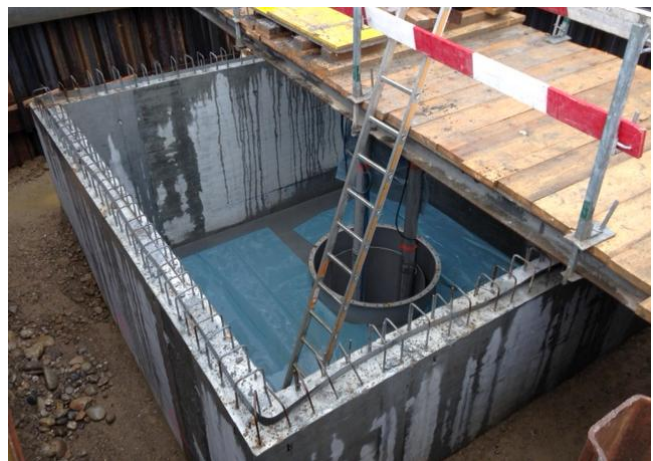
Grundwasserbrunnen in Aarau mit 1.8 MW
