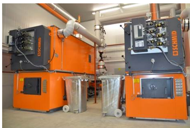
Holzsnitzelfeuerung Felben-Wellhausen (TG)
