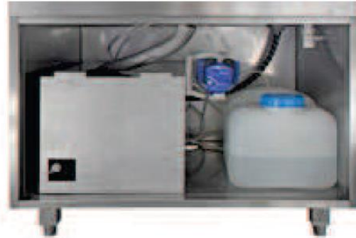
Abbildung 35: Unterbau Wassertank und Pumpe
