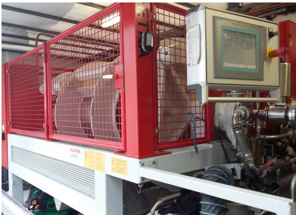
Nach dem Reaktor gelangt der Kohleschlamm in eine Presse, wo nach Abfluss des Prozesswassers die HTC-Kohle mit nur noch rund 30% Wassergehalt übrig bleibt. Foto: BFE-Schlussbericht
