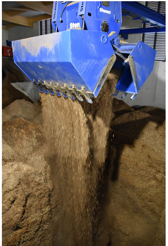
Aus dem Sägewerk fallen jährlich rund 10'000 m 3 Holznebenprodukte (Kernholz-Hackgut, Sägemehl, zerkleinerte Rinde) an, die im Holzheizwerk zur Wärmeproduktion genutzt werden. Die Nebenprodukte (vorwiegend Laubhölzer) sind sehr heterogen. Foto: Viteos.
