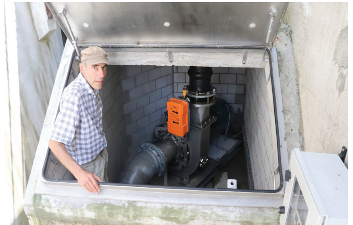
Peter Eichenberger mit dem Container, in dem das Kleinwasserkraftwerk untergebracht ist. Turbine und Generator ruhen auf Gummilagern, die Bewohner und Beschäftigte im Mühlegebäude vor Vibration und Schall schützen. Lauter als erwünscht sind die Ventilatoren des Frequenzumrichters (rechts im Bild, teilweise verdeckt). Foto: B. Vogel
