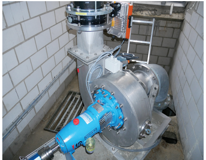
Im PaT-Francis-Projekt wird eine Abwasserpumpe als Francis-Turbine genutzt. Dieser Turbinentyp eignet sich für Wasserkraftwerke mit wenig Leistung und geringer Fallhöhe. Foto: Hydro Engineering
