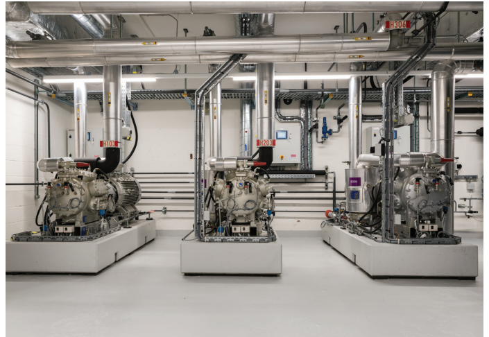
Zwei Niederdruckverdichter (links, Mitte) sorgen beim Pharmazulieferer Bachem AG in Bubendorf (BL) für Prozesskälte. Der Hochdruckverdichter (rechts) nutzt die Abwärme aus der Kälteproduktion zur Bereitstellung von Heizwärme und Warmwasser. Foto: eicher+pauli Liestal AG
