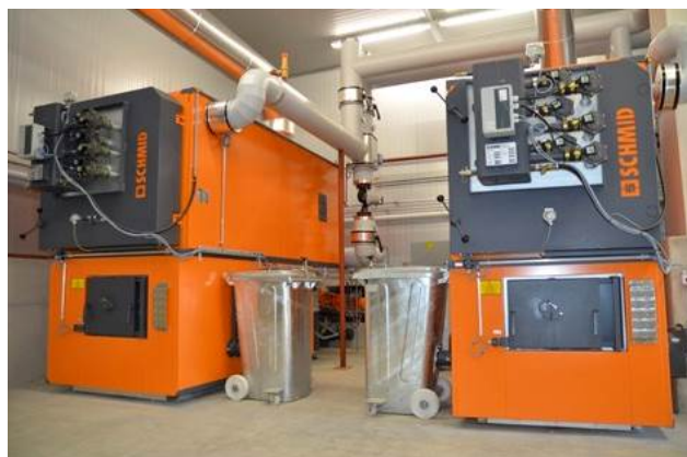
Holzsnitzelfeuerung Felben-Wellhausen (TG)
