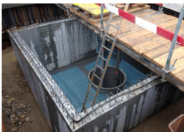
Grundwasserbrunnen in Aarau mit 1.8 MW
