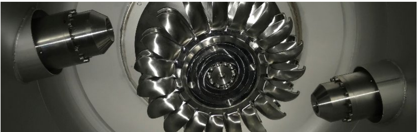
KWK Malatray in Monthey : Pelton-Laufrad mit zwei Injektoren, die aus verschiedenen Quellen gespeist werden (Quelle: Stadt Monthey)
