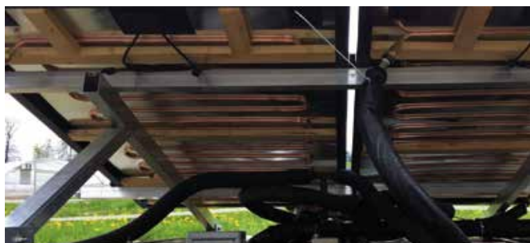
Strom und Wärme für die Wärmepumpe: Hier wurde ein herkömmliches PV-Modul nachträglich mit einem Wärmetauscher ausgerüstet (Quelle: ZHAW).
