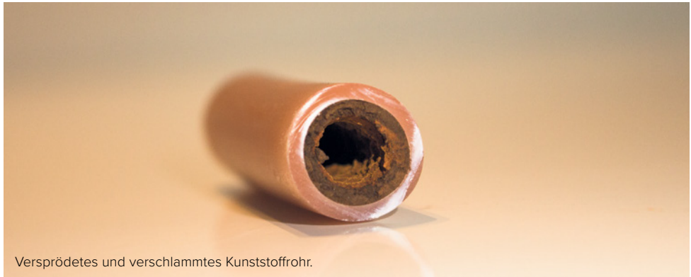
Versprödetes und verschlammtes Kunststoffrohr.
